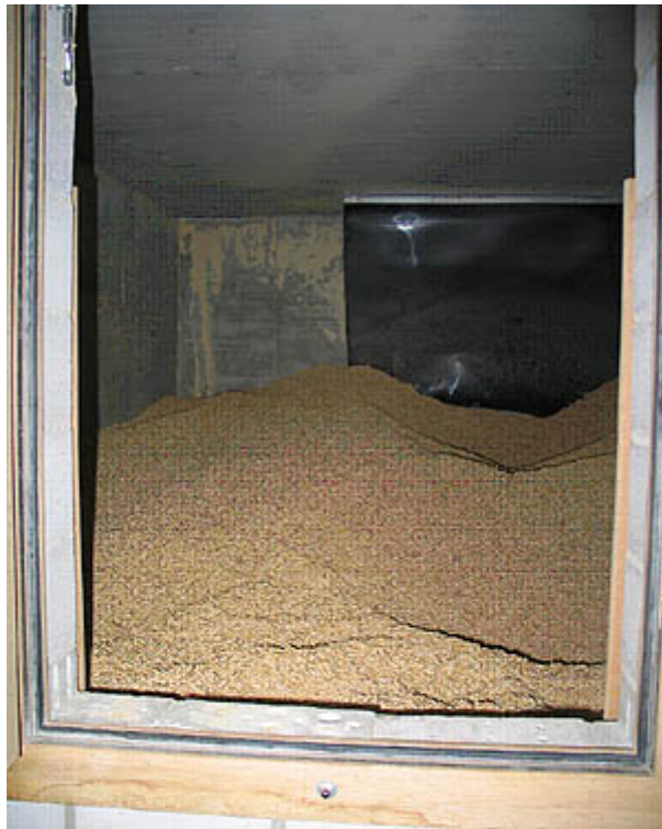
Halbvoller Pelletsraum mit Prallschutzmatte im Hintergrund
