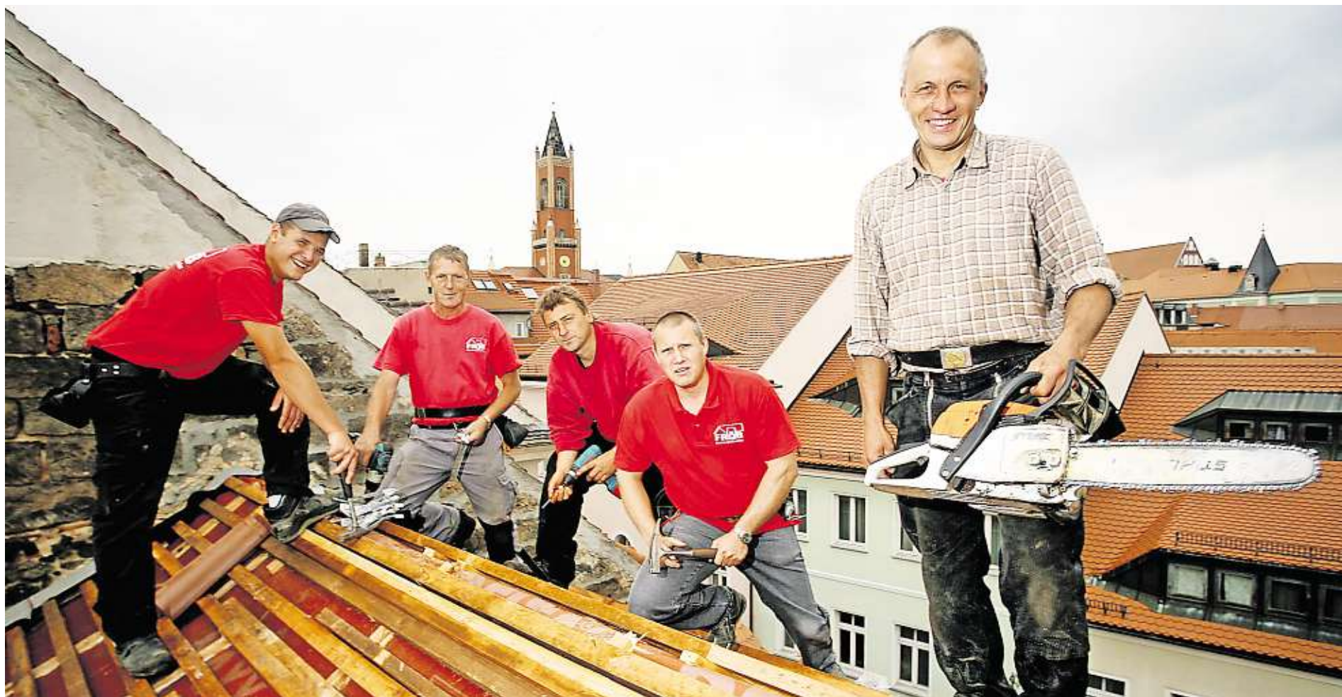
Chef Jürgen Fröb (2.v.r.) mit seinem Team bei der Arbeit. Derzeit decken sie ein Dach an der oberen Bautzner Straße und haben, wenn sie möchten, einen besonders schönen Ausblick auf die Altstadt. Auch das Rathaus lässt im Hintergrund grünen.
