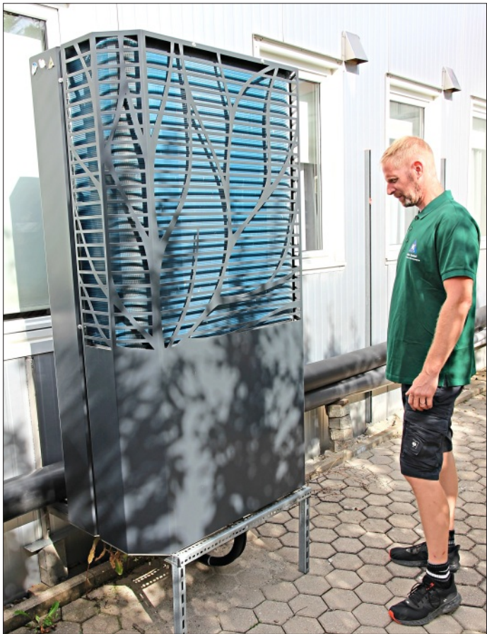
Miteigentümer Mathias Koller an einer Wärmepumpe, eines der Haupt-Standardbeine des Betriebs. Die Firma war schon in den 90er Jahren des vorigen Jahrhunderts Pionier in dieser Technik.
