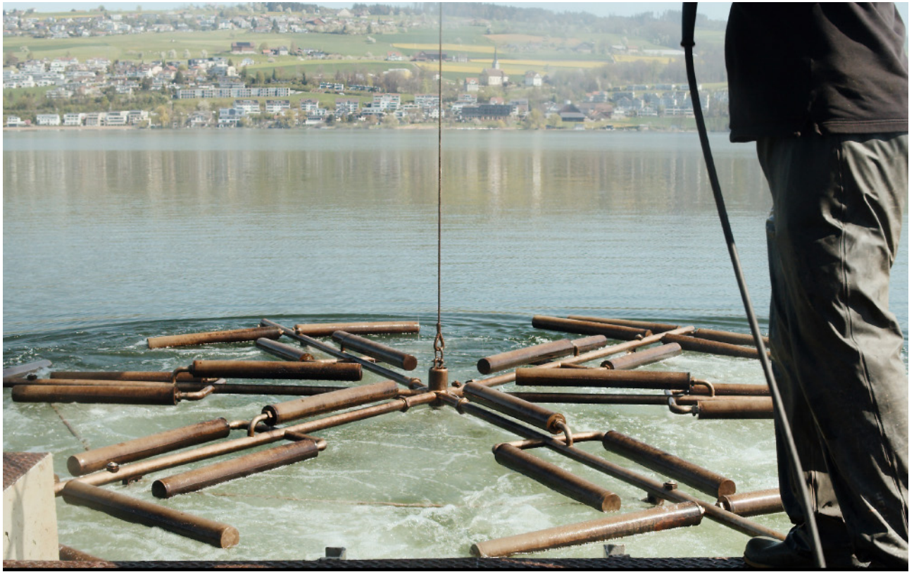
Abbildung 40: Reinigung der Aggregate zum Einbringen der Druckluft. Die sogenannten Fritten ermöglichen den Eintrag von Luft in ganz kleinen Blasen, die nicht sofort an die Oberfläche steigen und der Sauerstoff so in der Tiefe verbleibt. Foto: Julian Walss
