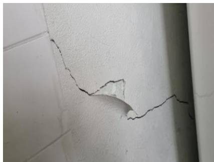
Fissure structurelle avec éclatement du parement
