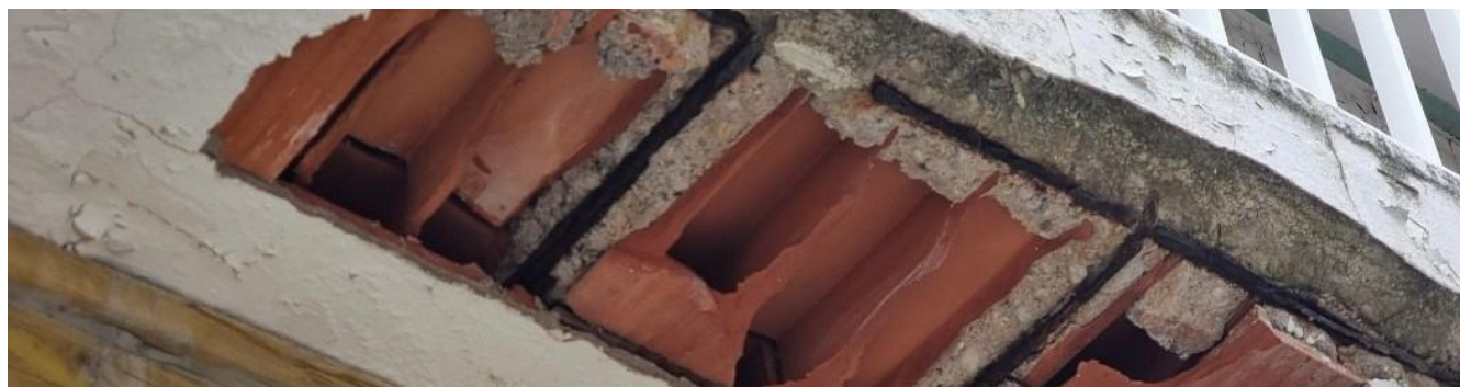
Dalle de balcon dégradée surplombant un espace accessible au public — risque avéré de chute de matériaux.
