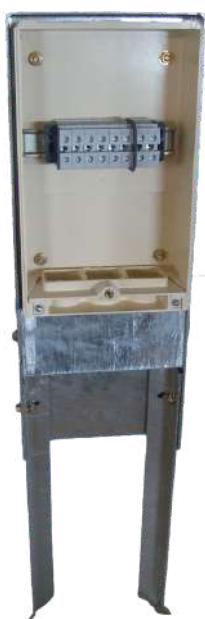
Mesure dans coffret S100
