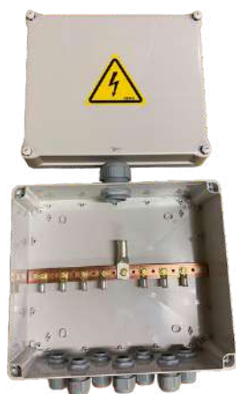
Répartition dans boîte de dérivation
