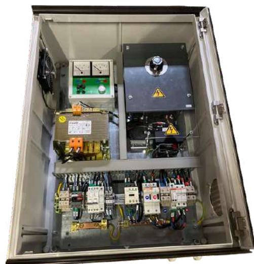
Soutirage éclaté dans un coffret
