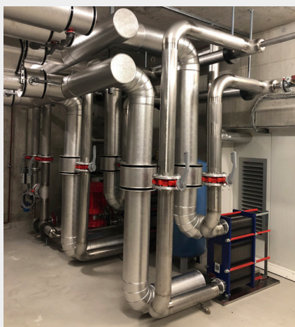
Central de chauffe (Source : SIG).
