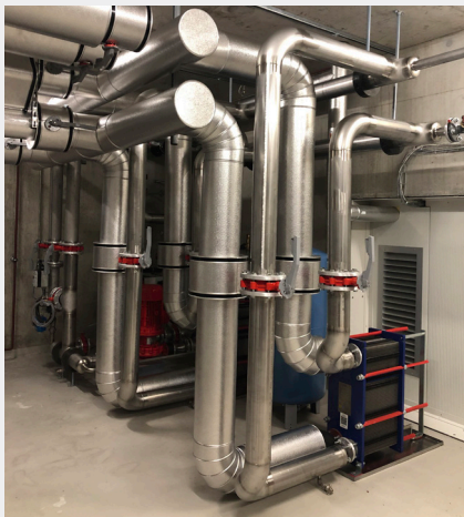
Heizzentrale (Quelle: SIG).
