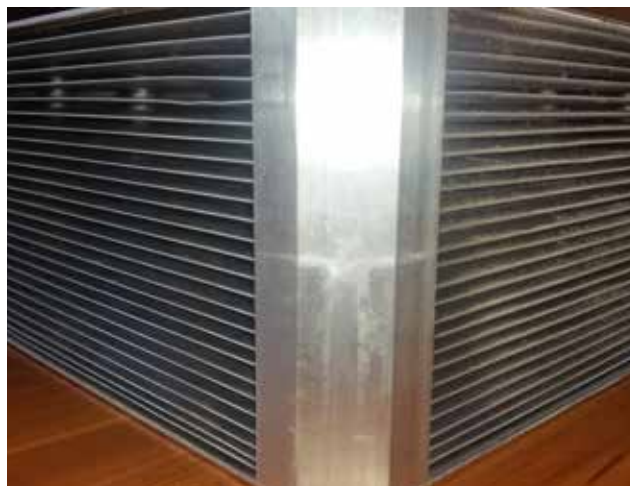
Nach vielen Jahren Dauerbetrieb zeigt der ausgebaute Kreuzstromwärmetauscher an den Lamellenein-/ausgängen nur leichte Staubablagerungen.
