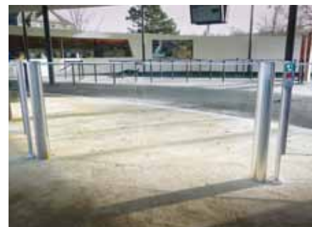
Drehtüren „Ingolstadt“, Kombination von zwei Türen im Synchronbetrieb als Fluchtwegausgang
