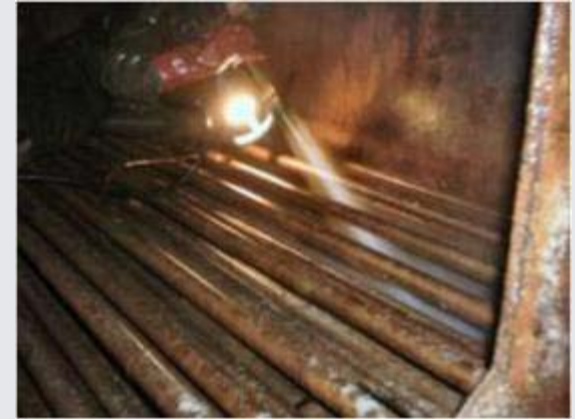
Limpeza de uma caldeira
