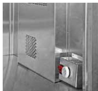
Termostaattilla varustettu hissikorin lämmitys
