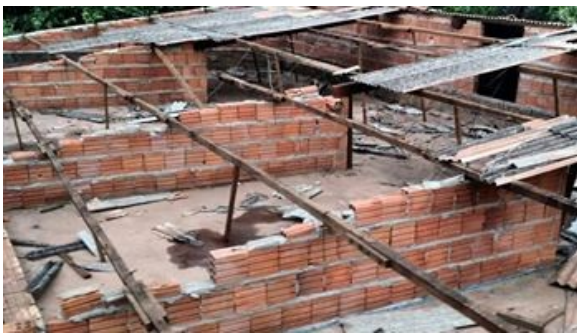
Zerstörung durch den Sturm
