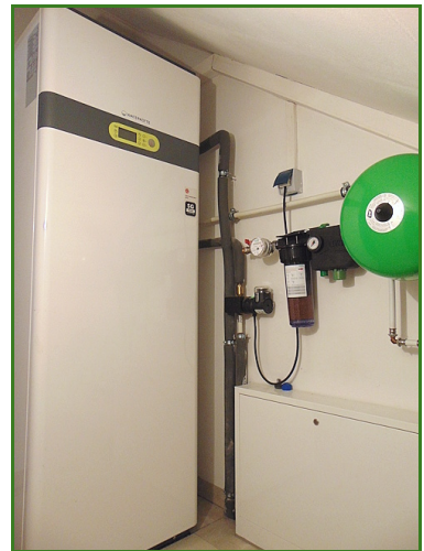
Technikraum im DG
