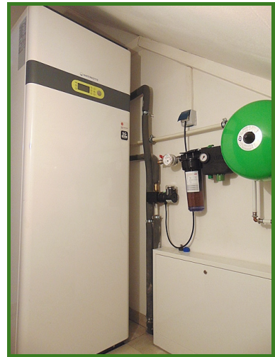
Technikraum im DG
