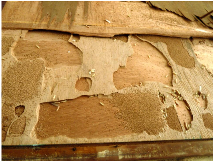
Dégradation due aux termites.
