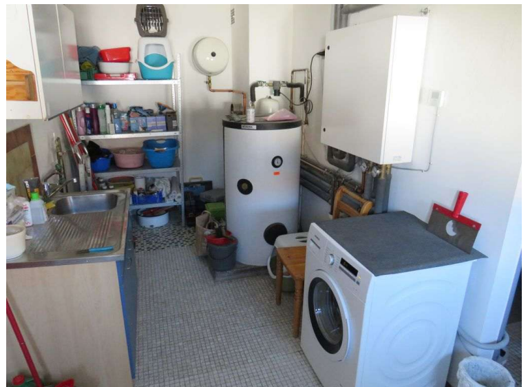
Hausanschlußraum im EG
