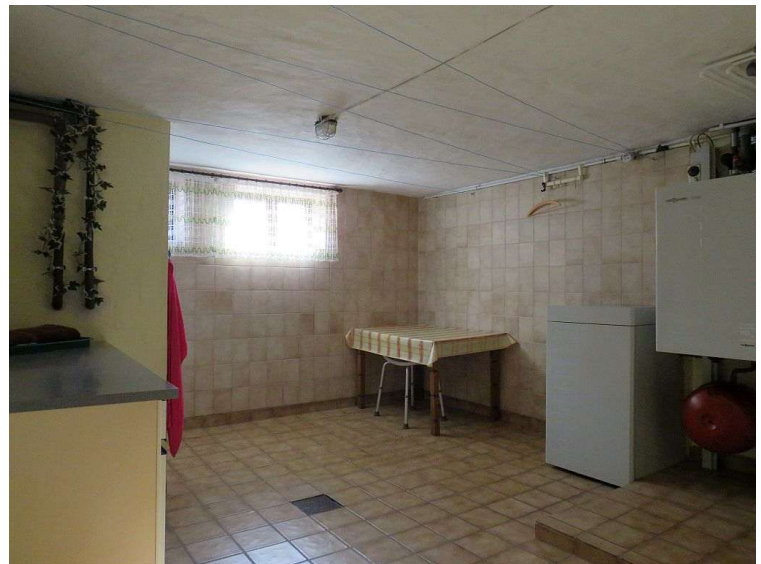
Heizungsraum im Keller
