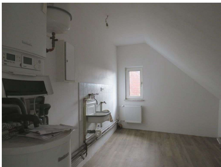
Anschlußraum Whg. 2 im DG
