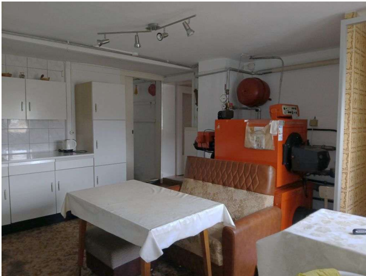
Anschlußraum im EG mit Zugang zum Haus
