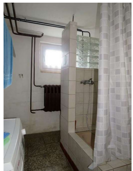
Anschlussraum im Keller
